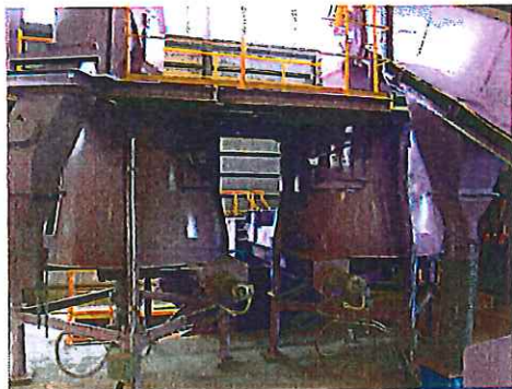
⑤ 定量供給機
