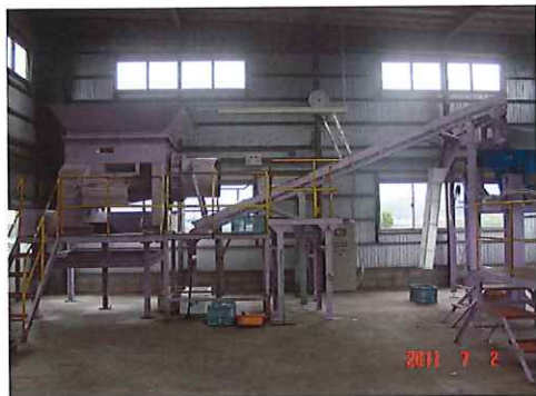
① 投入口(解碎機)
